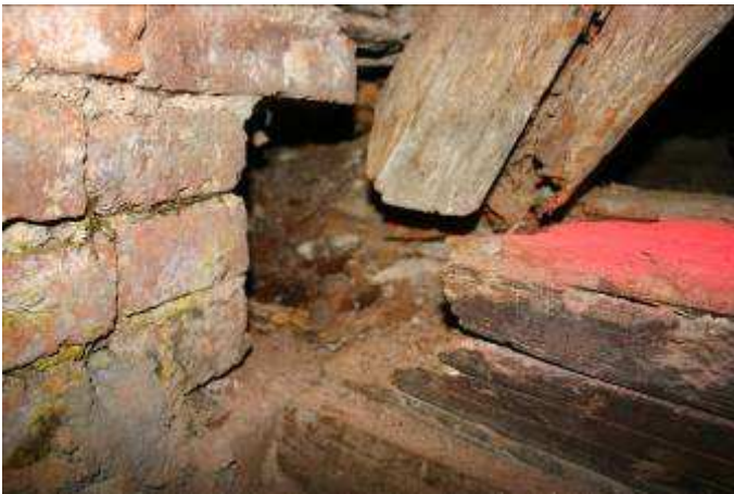
Über viele Jahre hat der echte Hausschwamm im Dach-, Kniestock- und Balkonbereich die Holzsubstanz stark angegriffen und geschädigt.
